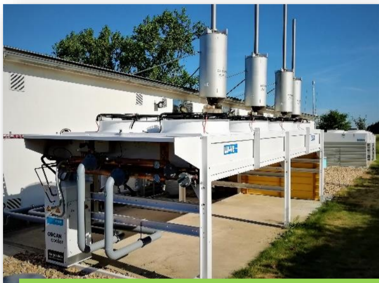
BPS Valečov 2 chladiče eCooler 600 kW
