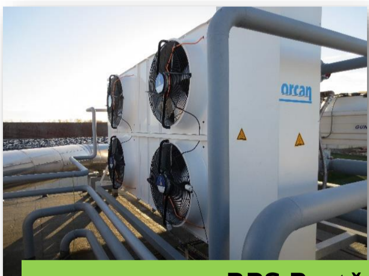
BPS Rostěnice Chladič eCooler 600 kW
